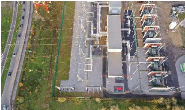
Luchtbeeld als voorbeeld van een bestaand GIS-onderstation te Lillo 380kV
