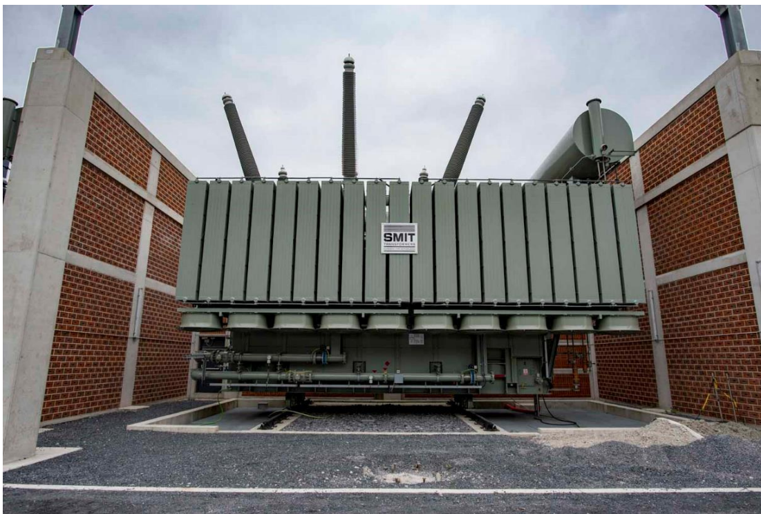
Figuur 6 - Transformator 220/380 kV
