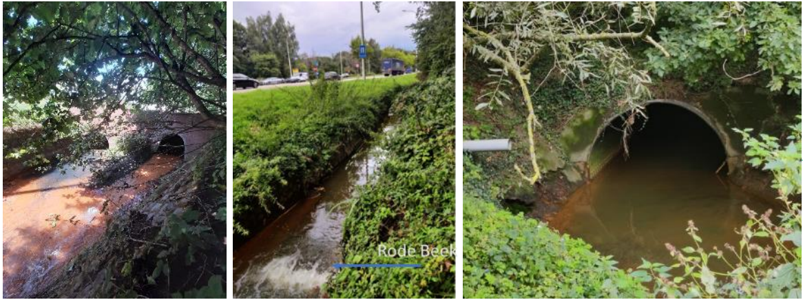
Figuur 7 - Afwateringssysteem ten oosten van de Grote Baan (N715). Links: bestaande uitwatering van de ingebuisde Groenstraatbeek naar open loop; Midden: bestaande diepe ligging van Groenstraatbeek naast de N715 met uitstroom van Rodebeek op hoger niveau; Rechts: Bestaande afvoerkoker van de Laambeek + Groenstraatbeek+ Rodebeek onder de N715.
