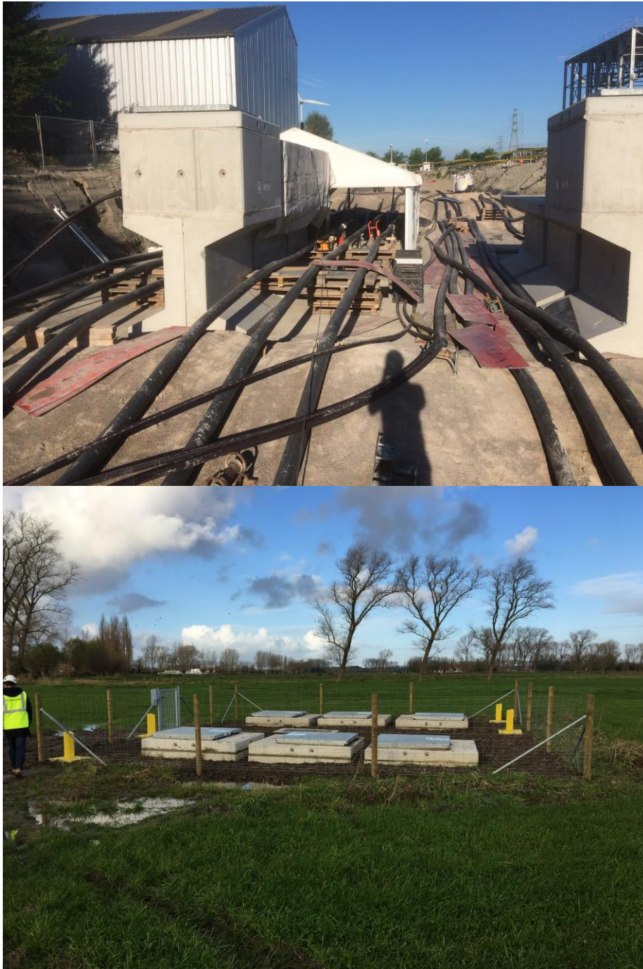
Figuur 15: Voorbeeld van mof- en inspectieputten tijdens en na de aanlegfase voor een 380kV-verbinding met 4 circuits
