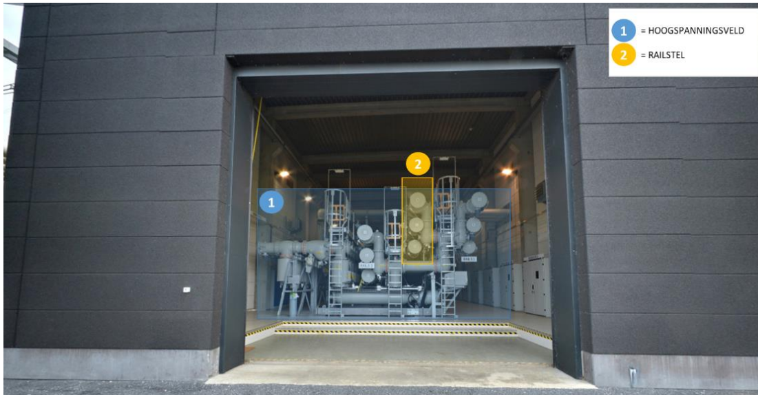
Figuur 20 - Onderdelen hoogspanningsstation type GIS (gasgeïsoleerde schakelapparatuur) – opgesteld in een gebouw
