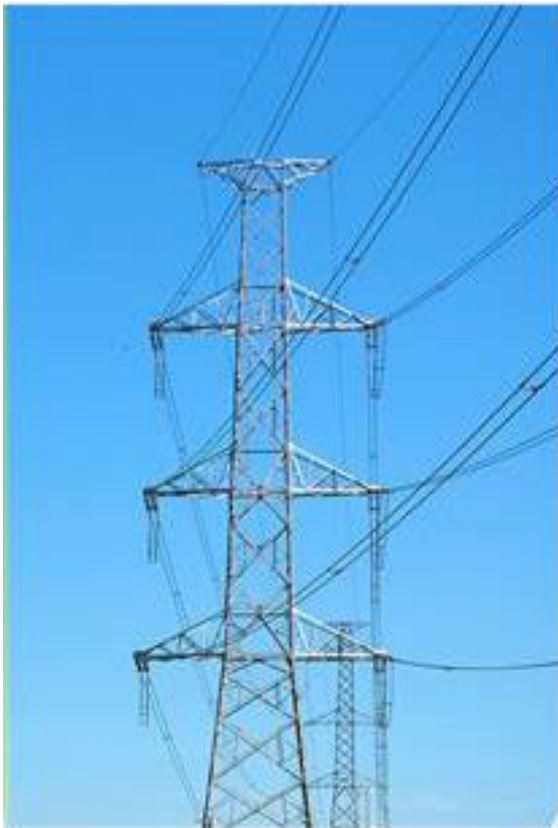
Figuur 2: Stalen vakwerkmast van 380 kV
