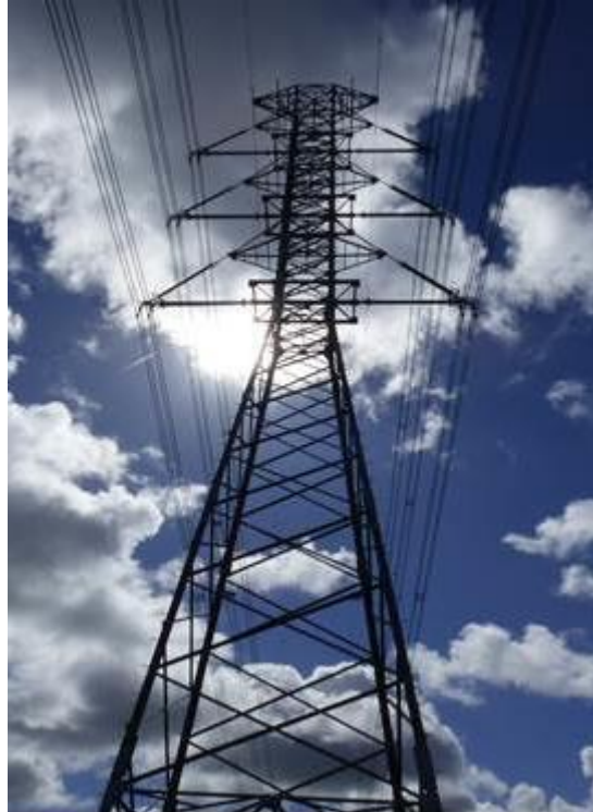
Figuur 5: Compacte mast van 380 kV
