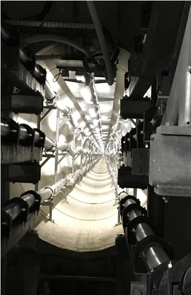
Figuur 7: Installatie van een tunnel voor een systeem met kabels van 380 kV
