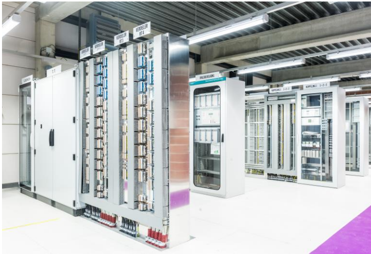
Figuur 25: Laagspanningsapparatuur in de relaiszaal
