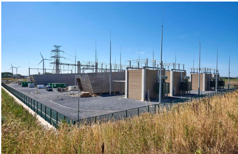
Figuur 16: foto bestaand hoogspanningsstation
