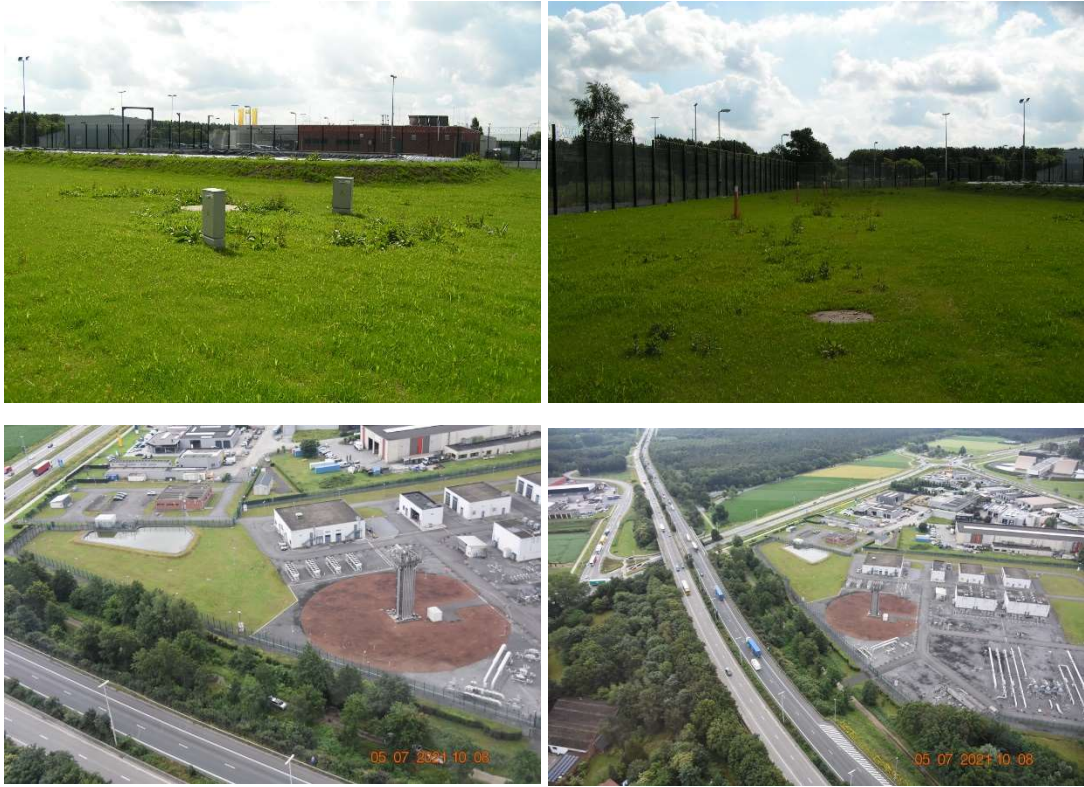
Figuur 6-71 Foto's compressiestation te Zelzate
