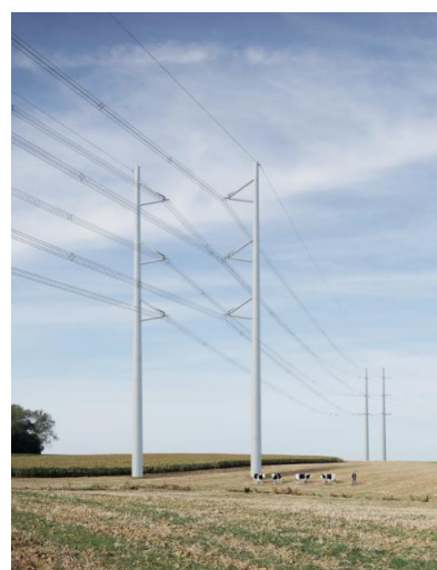
Figuur 20: Wintrack mast
