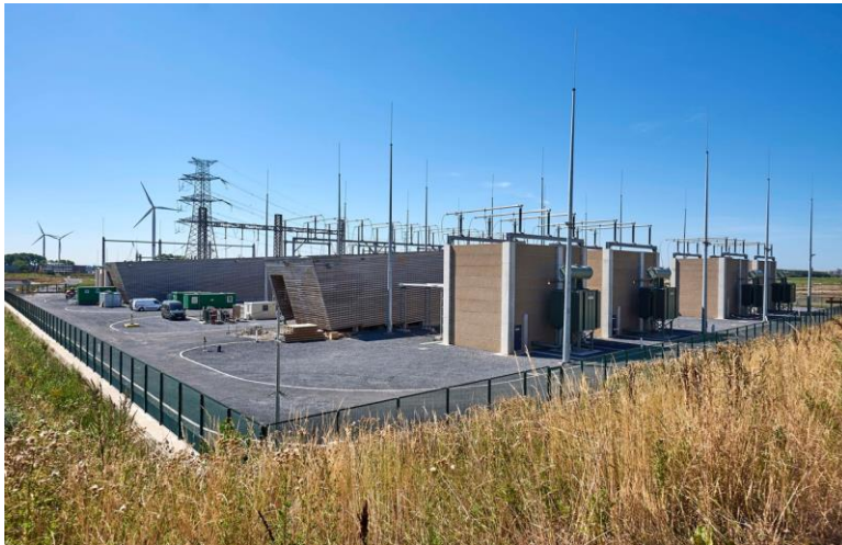
Figuur 16: foto bestaand hoogspanningsstation
