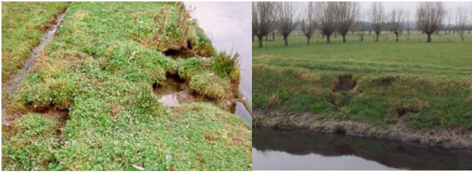
Figuur 1: Oeververzakkingen door graafschade van muskusratten.
