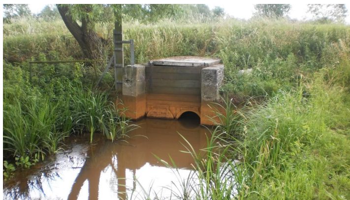
Figuur 8-9: Duiker van de Klein Pulsebeek onder het Netekanaal zicht naar stroomafwaarts, één terugslagklep afwezig
