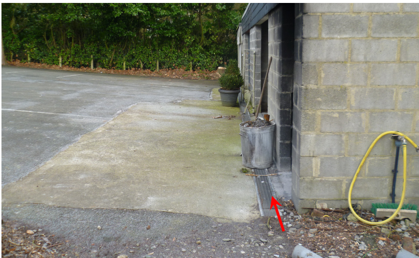
Figuur 5-8 Opvangrooster voor afstromend regenwater van de parking op het perceel van 't Kriekske
